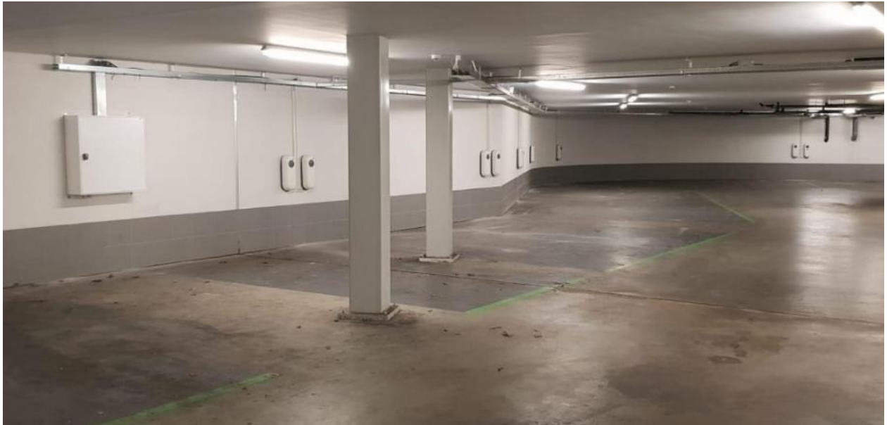
Foto: installatie Reith Power voor parkeergarage van Mooiland (bron: Reith Power)
