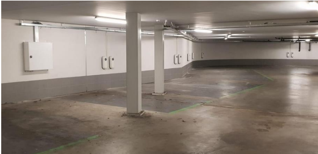
Foto: groeisysteem, installatie Reith Power voor parkeergarage van Mooiland (Laadpaalproject woningcorporatie Mooiland)
